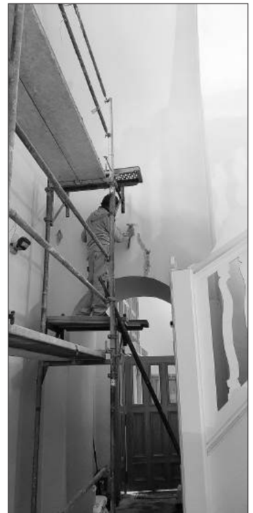
Spinanie odkrytych pęknięć ścian w nawie bocznej kościoła
