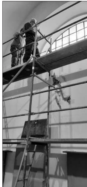
Odkryte pęknięcia wewnątrz kościoła i ich spinanie
