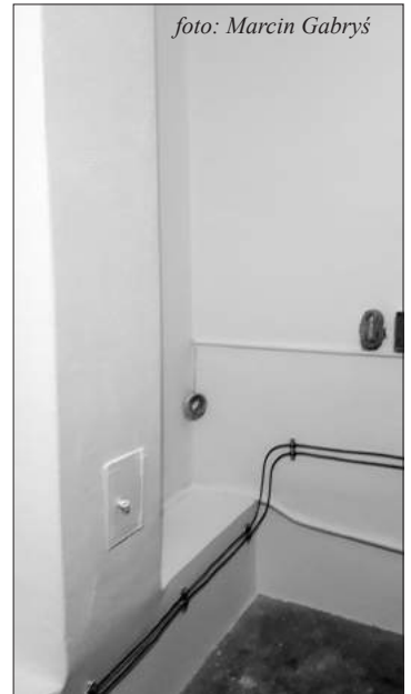
Odmalowane pomieszczenia kotłowni w kościele
