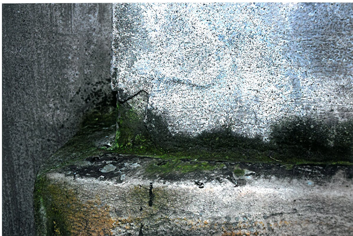
Elewacja główna – fragment cokołu. Stan zachowania przed konserwacją. Widoczne zawilgocenia, zabrudzenia, grube nawarstwienia mchu i porostów.
