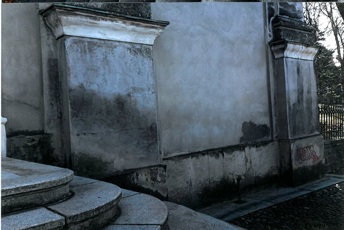
Elewacja główna – fragment. Stan zachowania kościoła przed konserwacją. Tynki cementowe, widoczne zawilgocenia, zabrudzenia i warstwy mchu.
