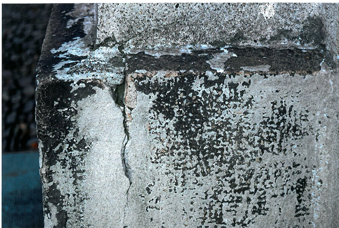
Elewacja główna – fragment kamiennego cokołu. Stan zachowania przed konserwacją. Widoczna warstwa cementu na powierzchni kamienia, zawilgocenia, zabrudzenia, mikroflora - mech i porosty, pęknięcia i ubytki mechaniczne.
