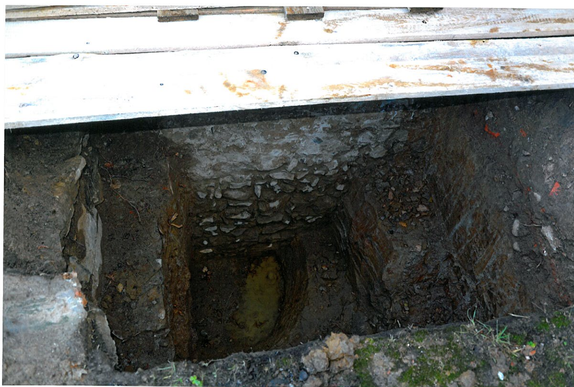
Elewacja południowa – odkrywka fundamentu nr 4. Stan zachowania kościoła przed konserwacją. Widoczna ściana fundamentowa z kamienia, brak izolacji i drenażu, zebrana woda w wykopie.
