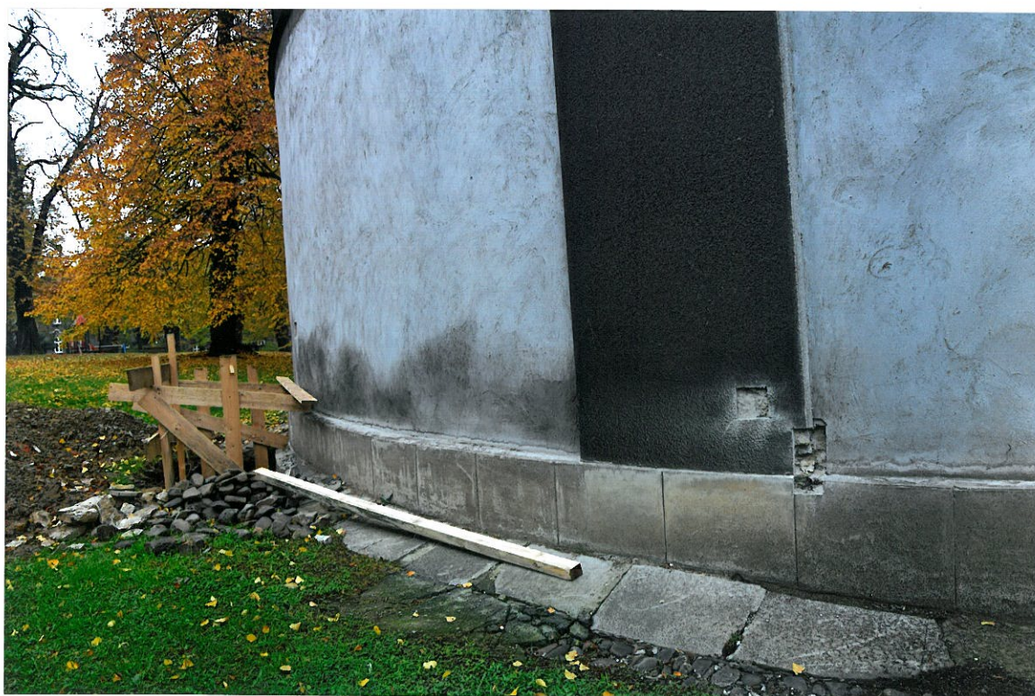
Elewacja wschodnie - fragment. Stan zachowania kościoła przed konserwacją. Tynki cementowe, widoczne betonowy cokół, zawilgocenia ścian i zabrudzenia.
