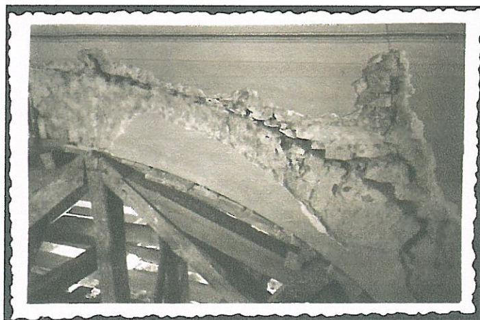
Stan zachowania kościoła w latach 50-tych XX wieku, widoczne uszkodzenia konstrukcyjne ścian i nadproży.
